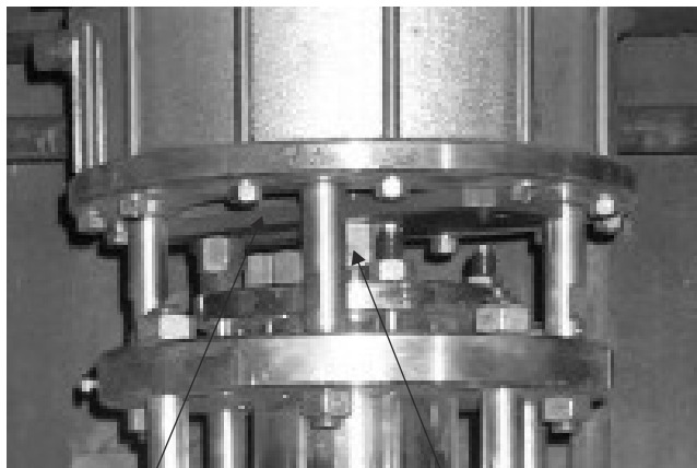
Zablokowany zawór bezp. przy próbie ciśnieniowej
